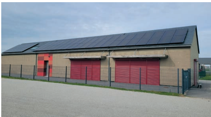
Panneaux photovoltaïques à l'école Gaston Bachelard
